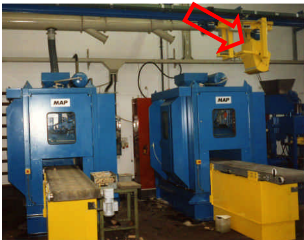
Abb.1: Beschickung von Kernschießmaschinen über eine Sandverteilerkatze (Pfeil)
