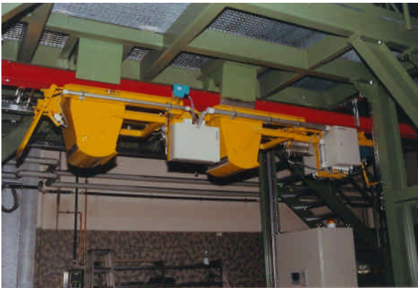
Abb. 3: Laufkatze mit Doppelbehälter, Beladung unter einer Mischerbühne
