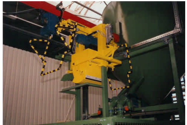
Abb.5: Übergang der Laufkatze von horizontal in vertikale Führung
