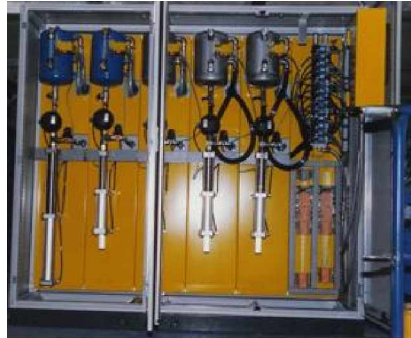
Bild 4: geöffneter Bindemitteldosierschrank mit den Dosiervorrichtungen für die einzelnen Komponenten
